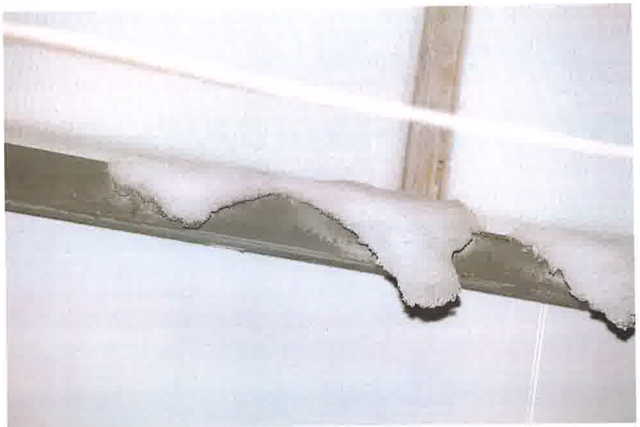
Фото 17. Дефекты монтажа кровли.
