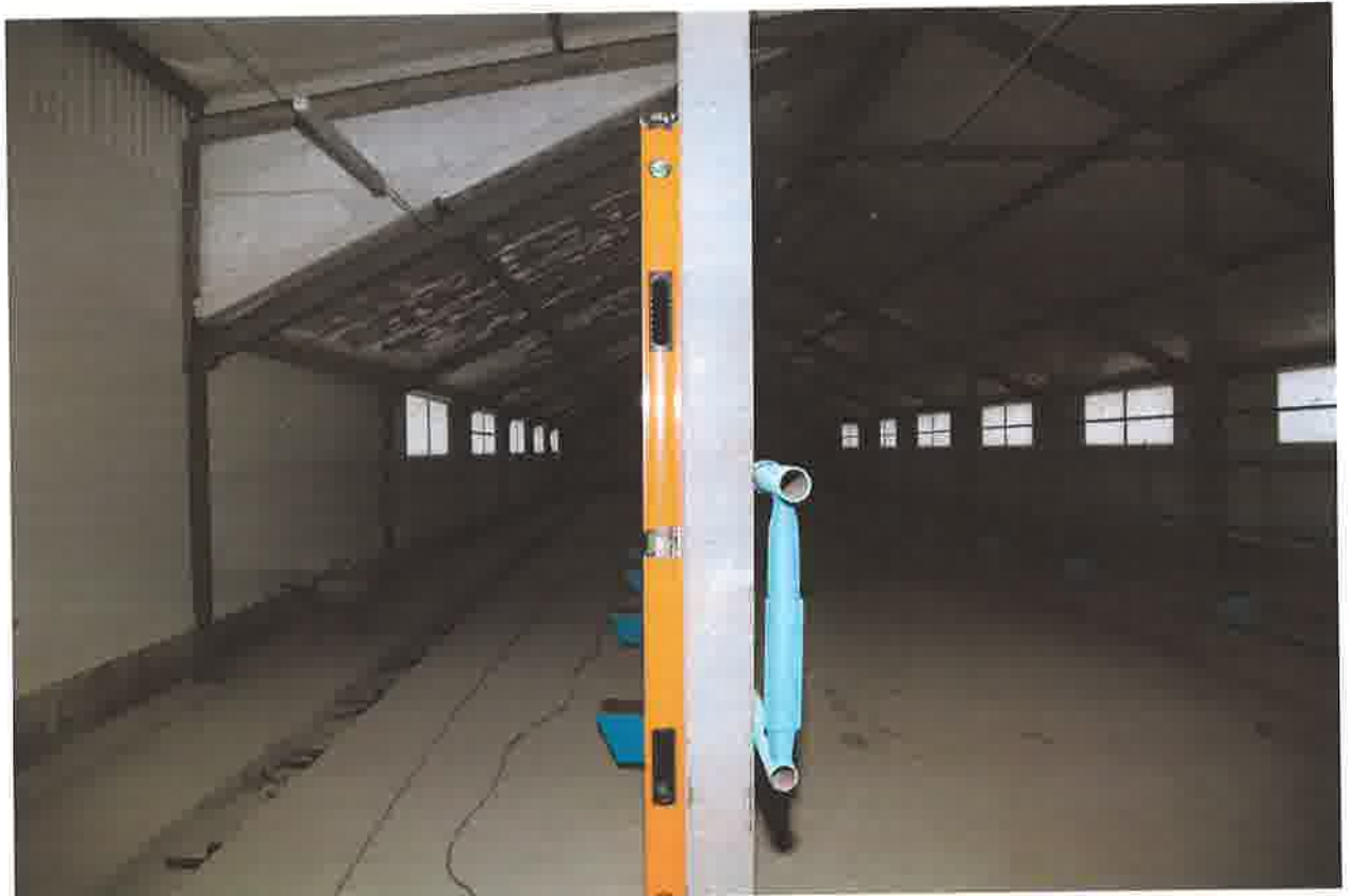
Фото 9. Отклонение колонны от вертикали.
