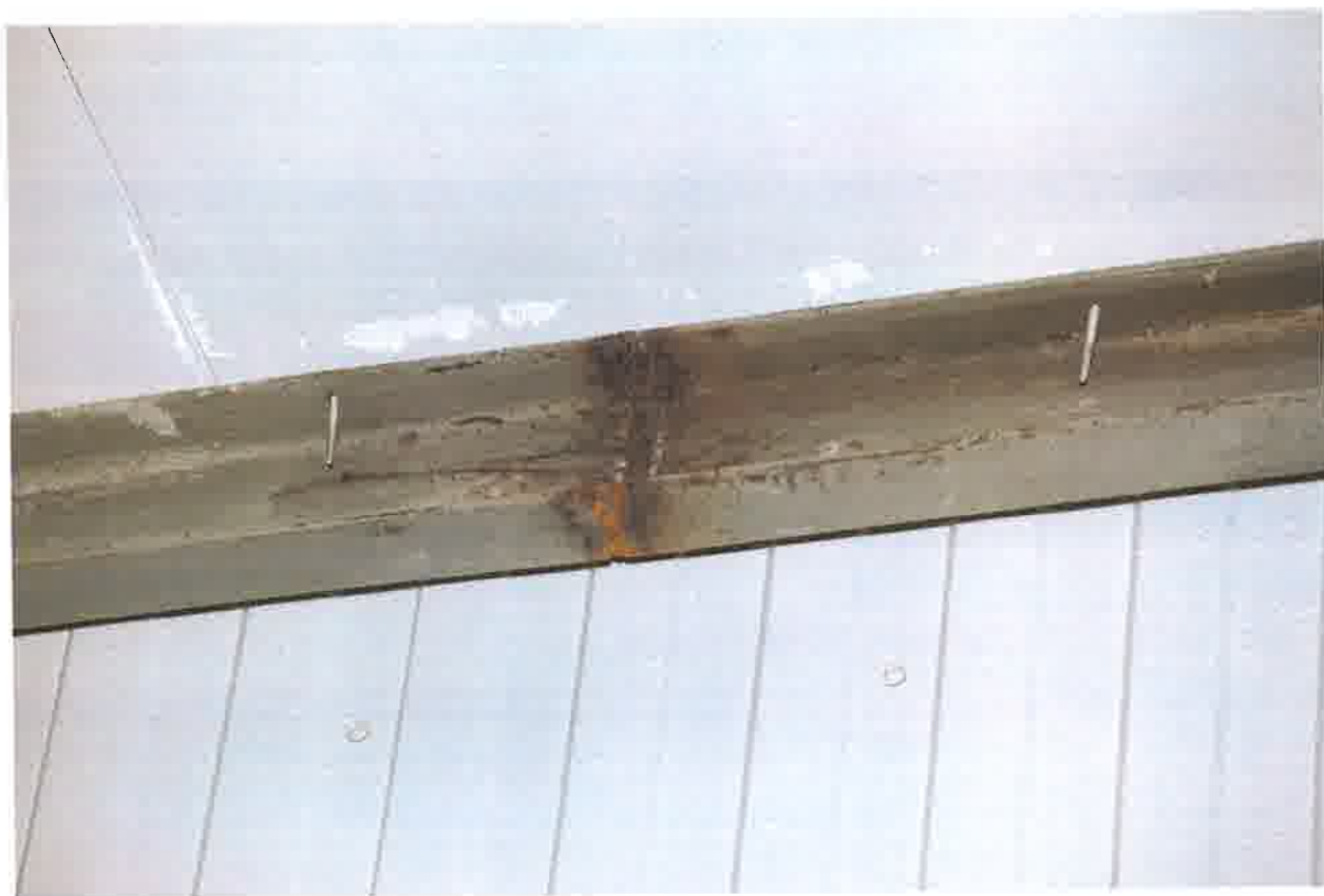
Фото 13. Не правильная стыковка прогонов.
