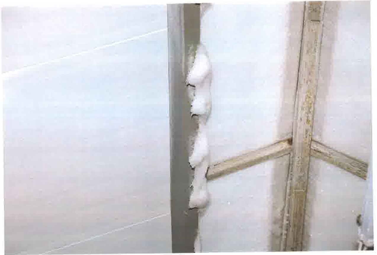
Фото 18. Дефекты монтажа кровли.
