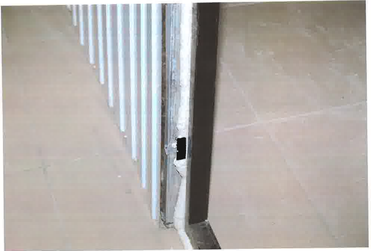
Фото 22. Дефекты установки металлических дверей.
