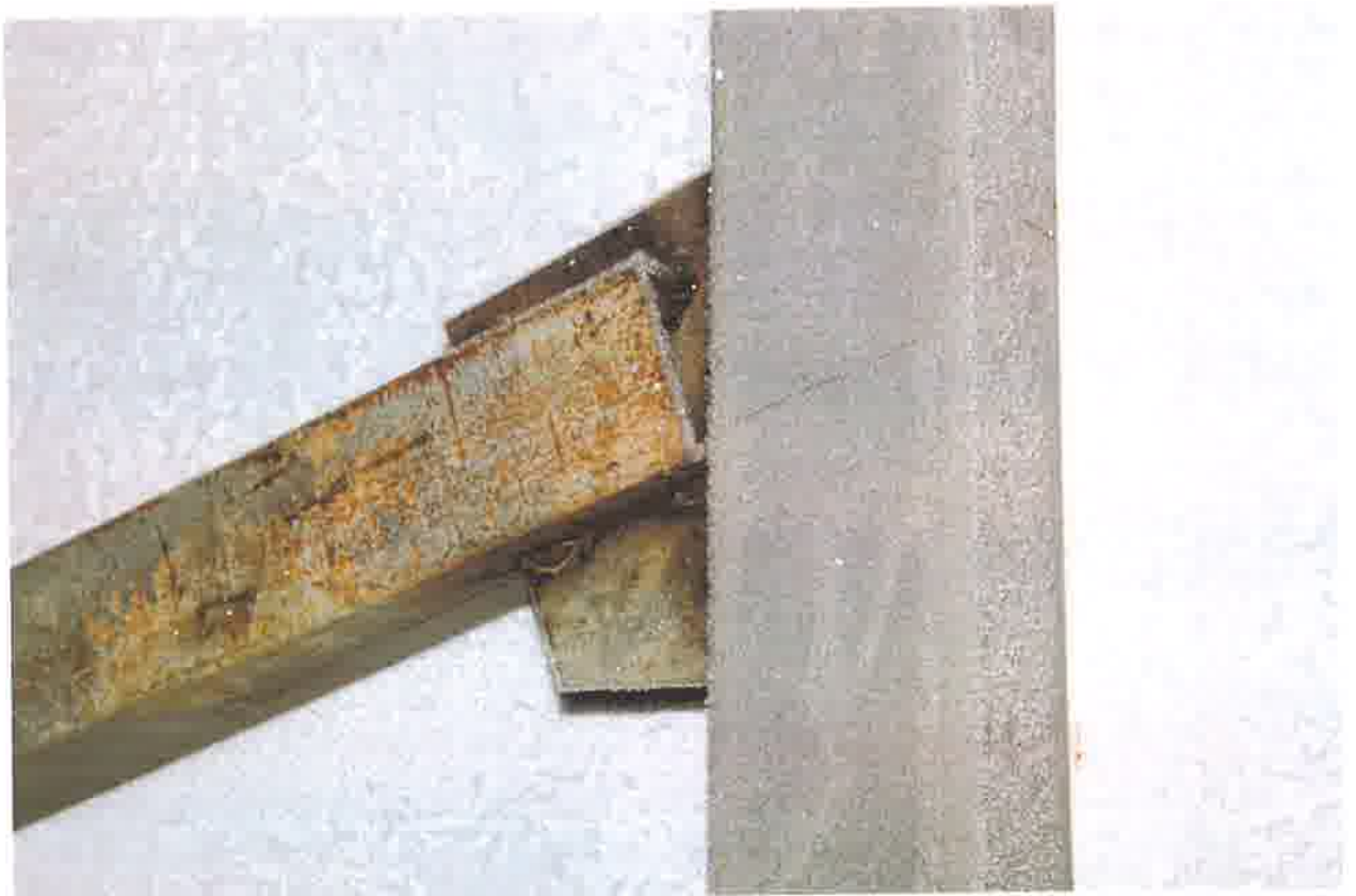
Фото 5. Не заварены торцы металлических элементов замкнутого профиля.
