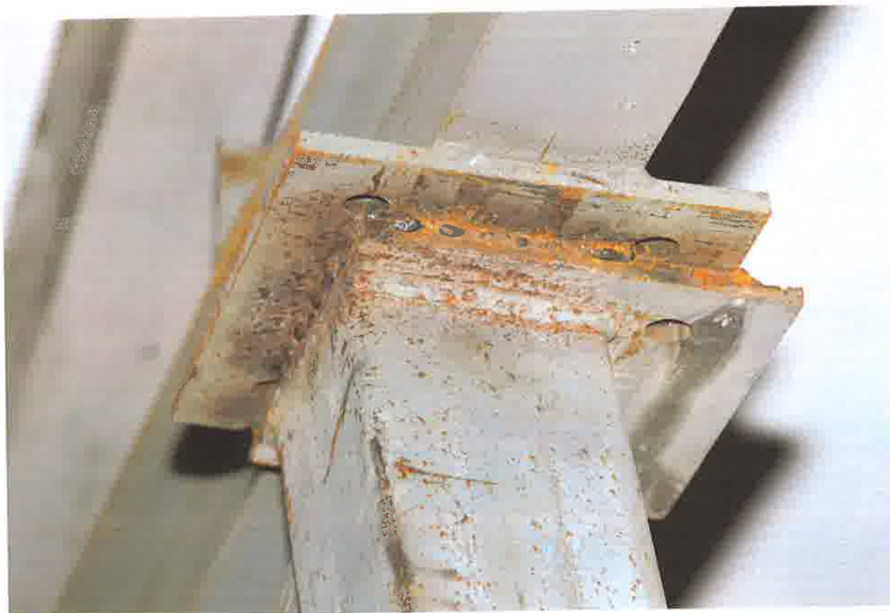
Фото 12. Не проектный узел крепления.
