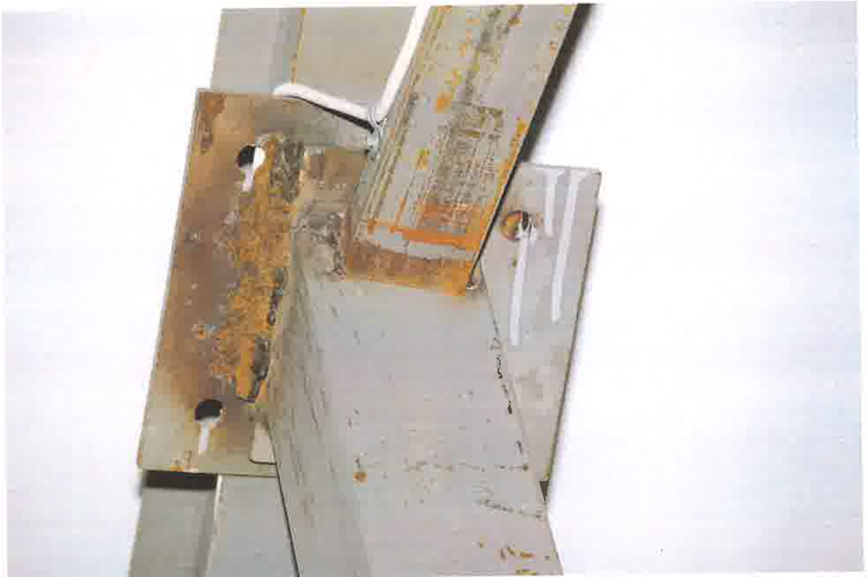
Фото 11. Не проектный узел крепления.
