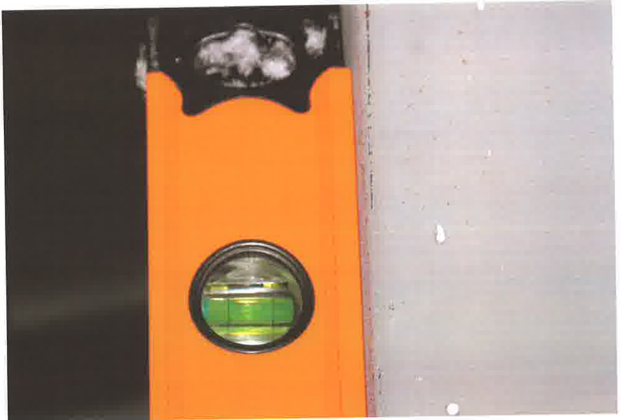
Фото 10. Отклонение колонны от вертикали.
