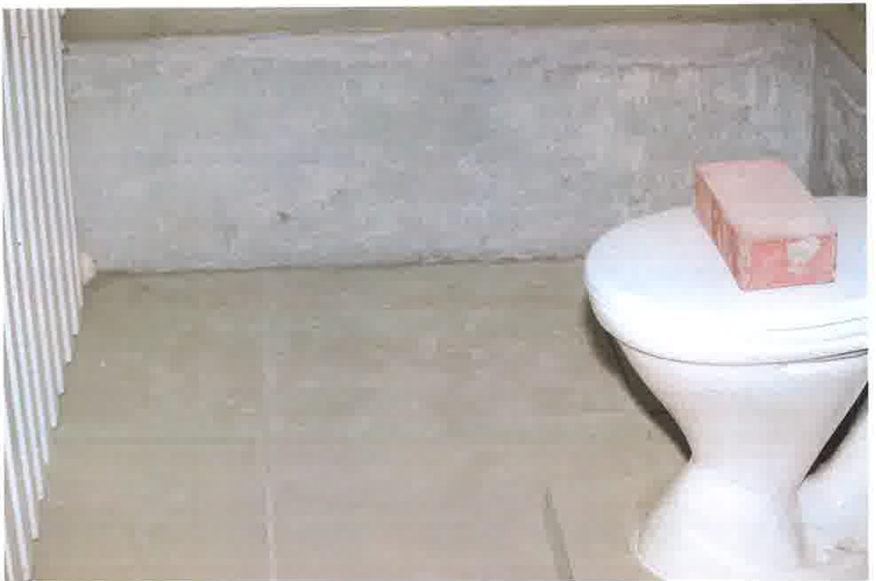
Фото 29. Отсутствие душевого поддона.
