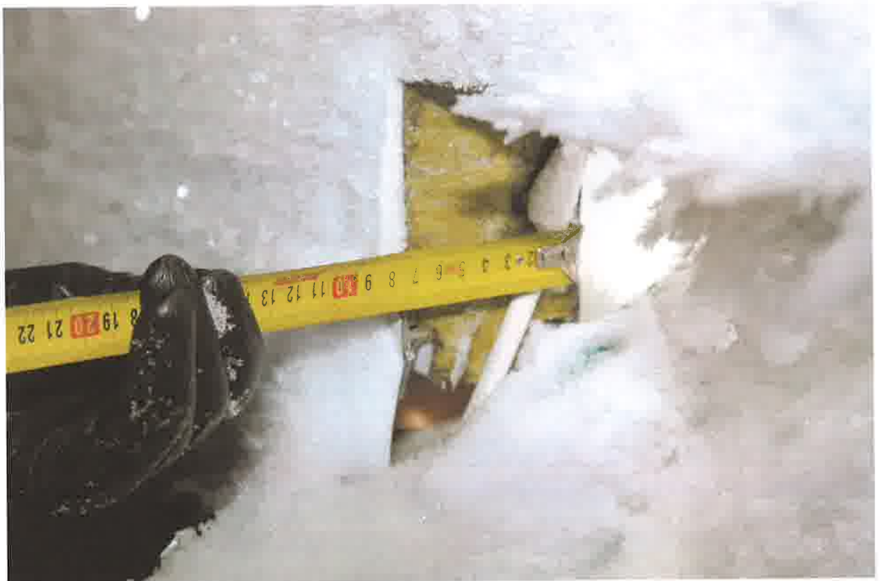
Фото 27. Толщина стеновых сэндвич-панелей. Отсутствие заделки торцов панелей.
