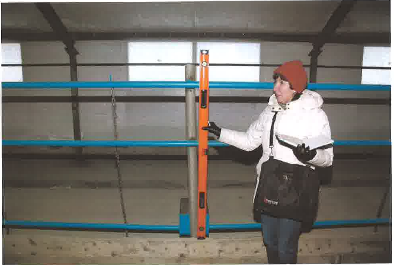
Фото 28. Отклонение от вертикали металлических стоек.
