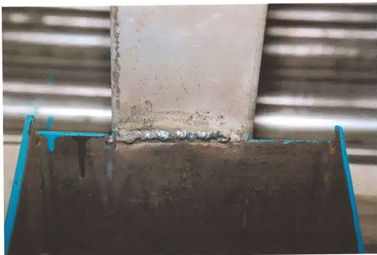
Фото 7. Не обработанные сварные швы.
