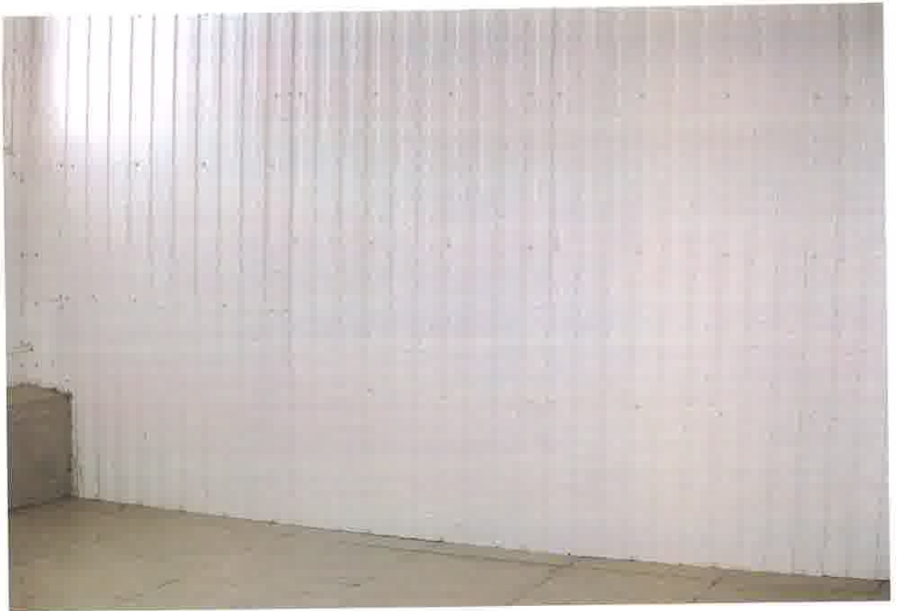
Фото 24. Внутренние перегородки. Отсутствие сантехприборов и подводок к ним.
