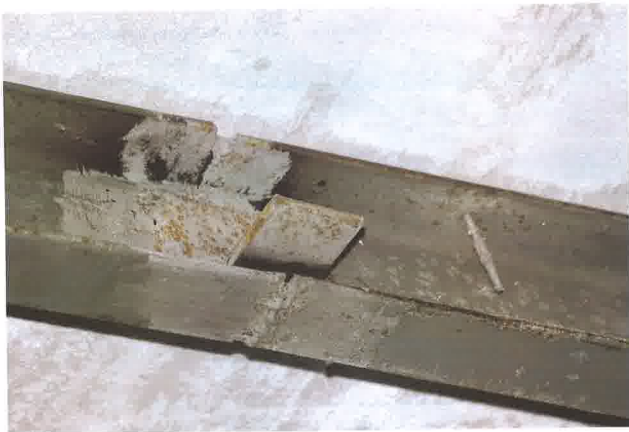
Фото 14. Не правильная стыковка прогонов.
