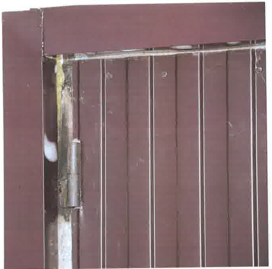
Фото 20. Дефекты металлических ворот.
