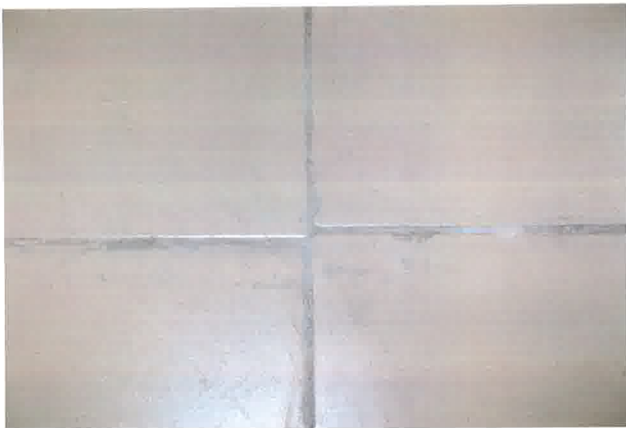
Фото 32. Дефекты укладки плитки пола.
